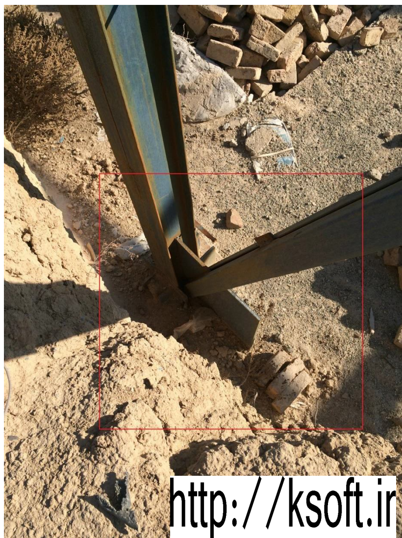
شکل شماره 29: عدم اتصال ورق به فونداسیون و صفحه ستون
