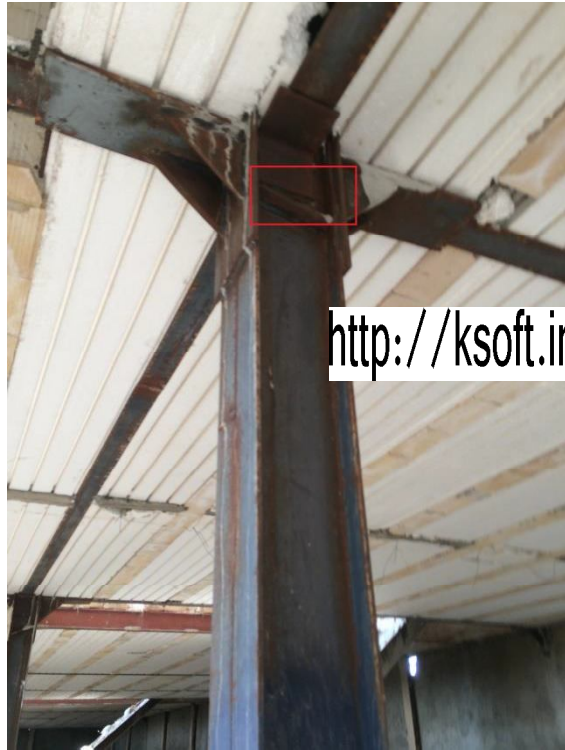
شکل شماره 9: عدم اجرای صحیح سخت کننده بال ستون
