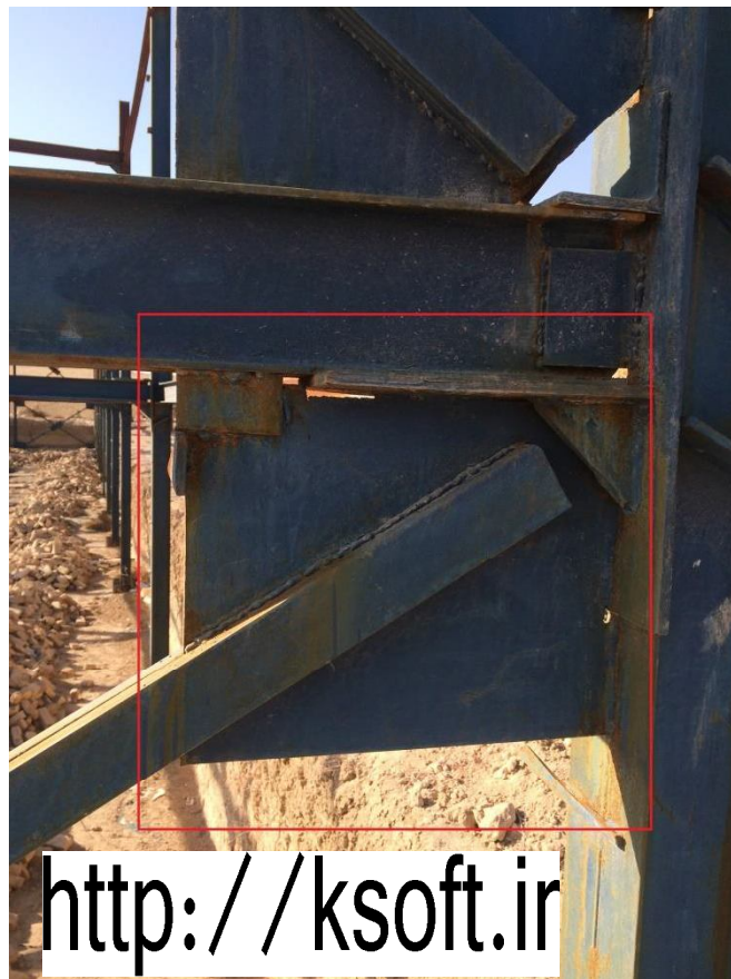
شکل شماره 17: اتصال نادرست ورق باد بند به تیر
