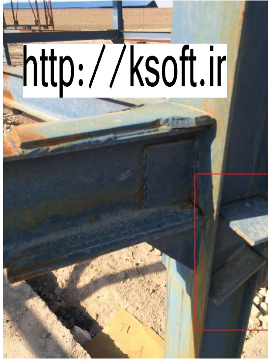
شکل شماره 16: اجرای نادرست سخت کننده
