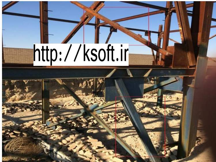
شکل شماره 23: عدم استفاده از ورق های وصله در طول مهاربند ها
