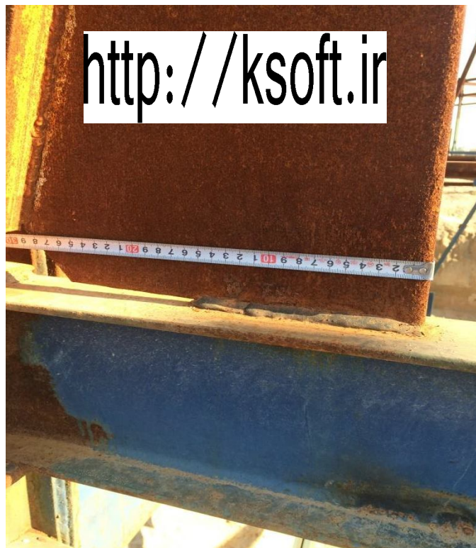
شکل شماره 28: کوتاه بودن جوش در اتصال ورق به تیر
