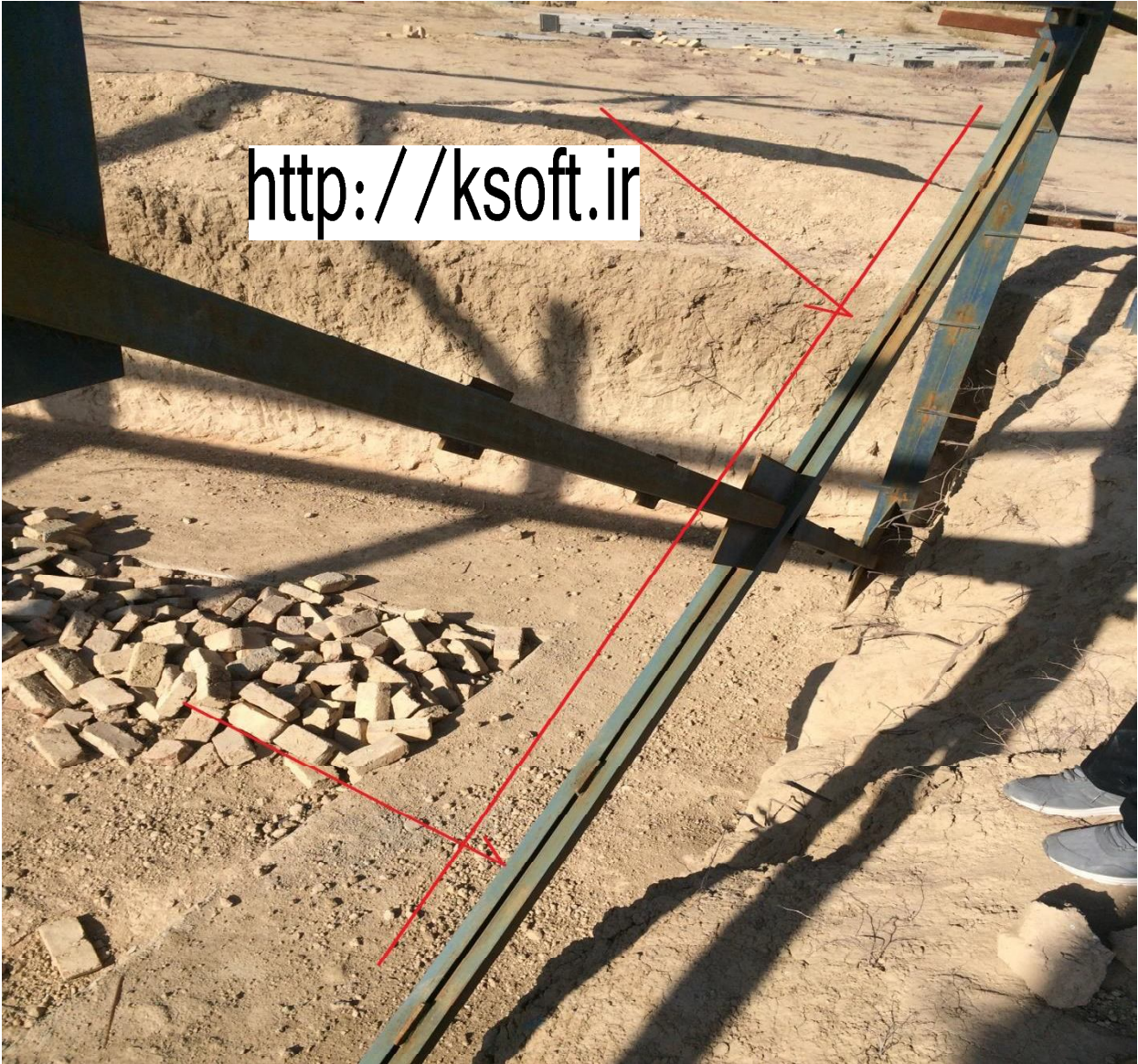
شکل شماره 13: عدم استفاده از بست در طول مهاربند تغییر راستای مهاربند
