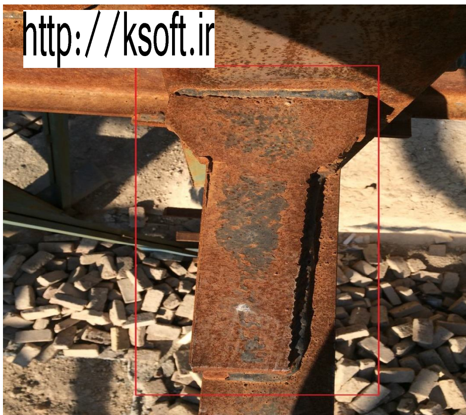
شکل شماره 24: نداشتن جوش کافی در اتصال کله گاوی پوسیدگی بیش از حد ورق
