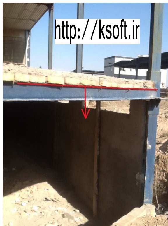
شکل شماره 8: تغییر شکل بیش از اندازه تیر C5-4
