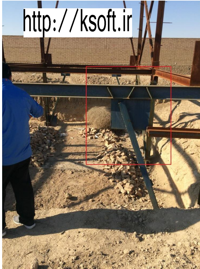
شکل شماره 21: اجرای نادرست سخت کننده‌ها در مهاربند و اگر
